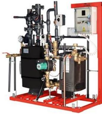
Şekil 20. Bina Altı Sıcak Su Hazırlama ve Isıtma İstasyonu [6]
