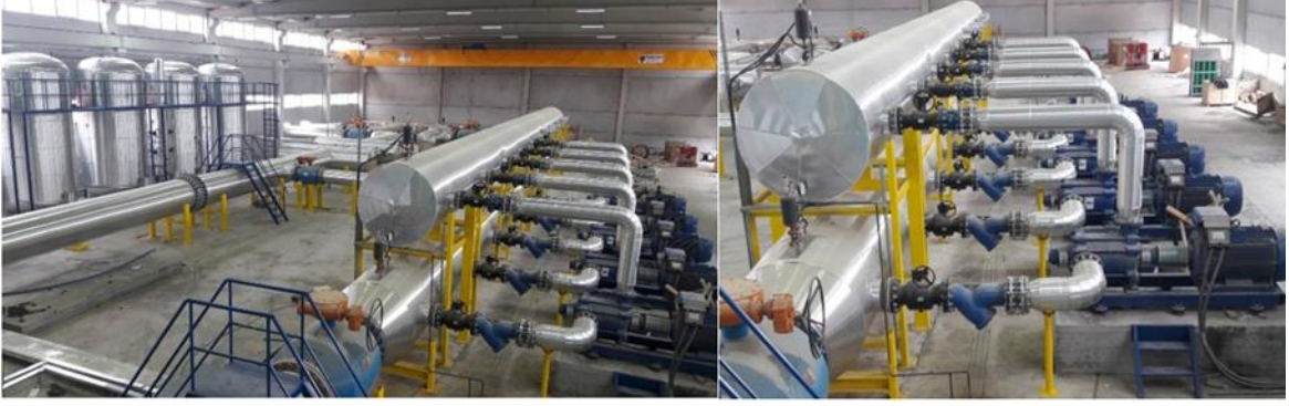
Şekil 1. Ana Pompa İstasyonu Örneği
